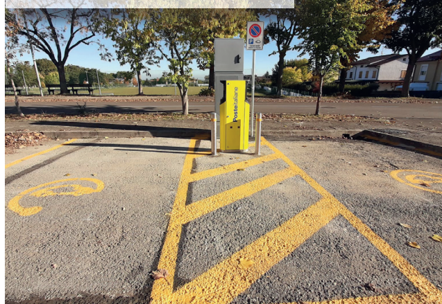
La colonnina di ricarica elettrica a Borzano
