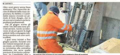
Un operaio Tim al lavoro in un centro di telecomunicazioni di Bebbio.
