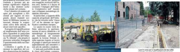
Lavori in corso per la qualificazione dei due edifici scolastici, con ampliamenti per la struttura.
