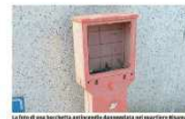
La foto di una bocchetta antivecchiata danneggiata nel quartiere Mianini
