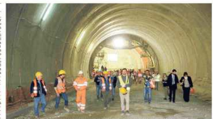
L'ultimo diaframma della galleria Bocco-Canala è stato abbattuto nel pomeriggio. La galleria sarà aperta al traffico alla fine dell'estate
