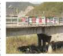
Il ponte sul rio Sologno dal 12 aprile è vietato il transito pesante visto lo stato della struttura
